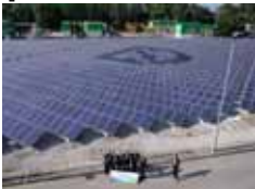
小蠔灣污水處理廠的大型太陽能發電場
