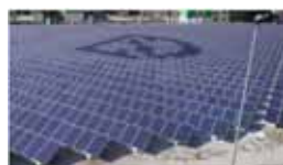
渠務署小濠灣污水處理廠太陽能發電場
